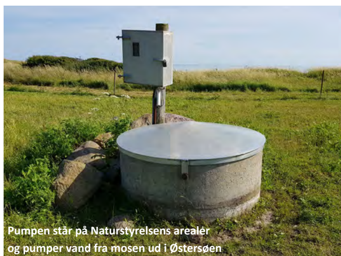
Bygværket hvor mosens vand gennem rør pumpes ud til havet
